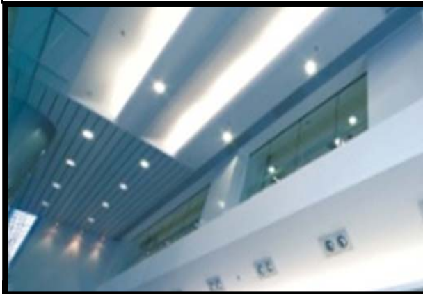
照明系統 (Lighting System)
